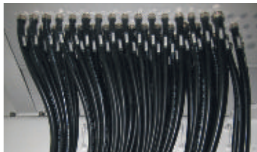
Aansluiting op kasten d.m.v. slangen
